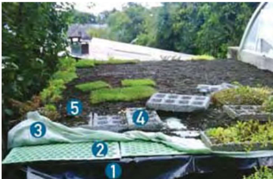
Figura 23 – Visão do sistema alveolar ecotelhado
