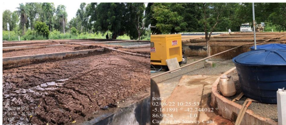
A. Tanque com lodo após a separação do efluente; B. canalização que leva o lodo até o tanque.
