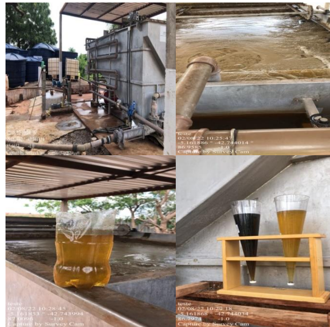
A e B. Flotador fazendo o processo de separação do efluente tratado e do lodo; B. C. Efluente tratado; D. Diferença entre efluente tratado e não tratado. Fonte: Arquivo pessoal das autoras, 2022.
