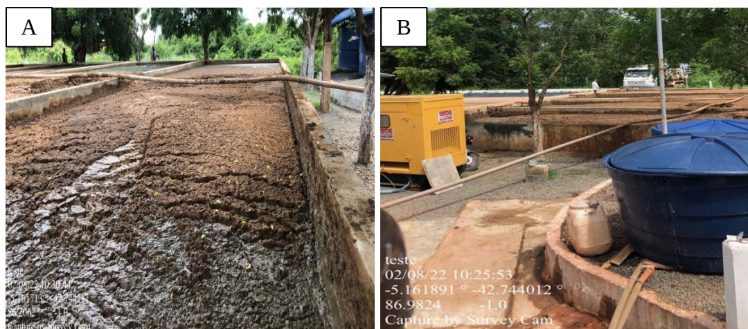
A. Tanque com lodo após a separação do efluente; B. canalização que leva o lodo até o tanque.
