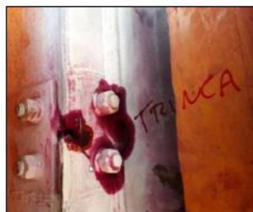
Figura 3 – Ensaio por líquido penetrante em uma trinca na recuperadora
