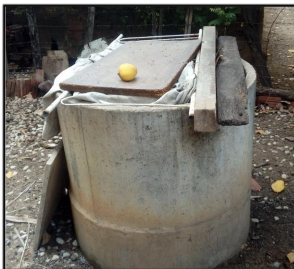
Figura 23: Fotografia do poço coberto por sacos, madeiras e restos de ferro enferrujado.
