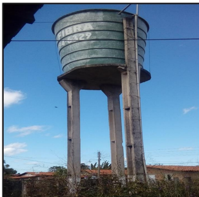
Figura 34: Fotografia do reservatório de distribuição da água do poço tubular central da Alegria.
