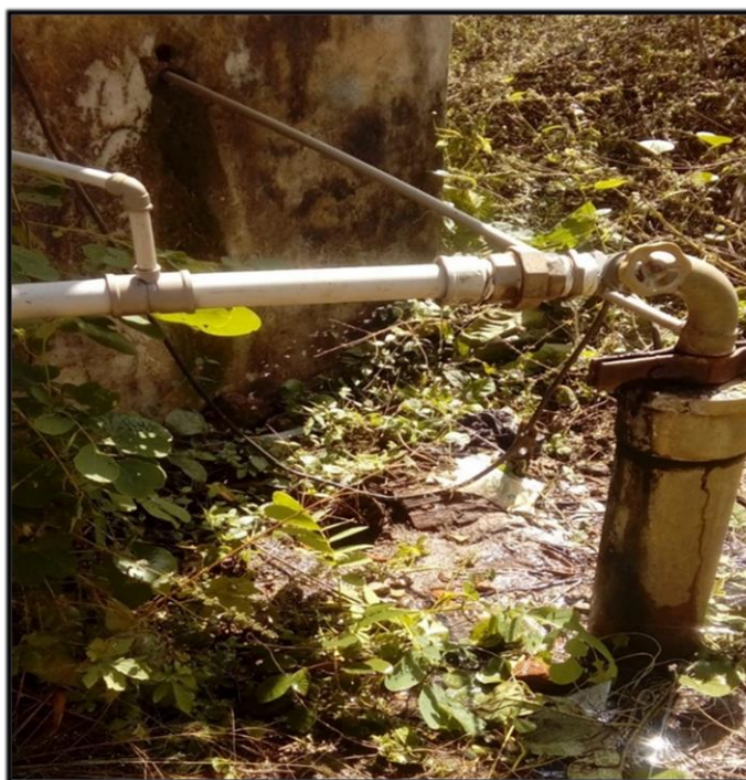
Figura 32: Bomba de captação do poço tubular central da Alegria.
