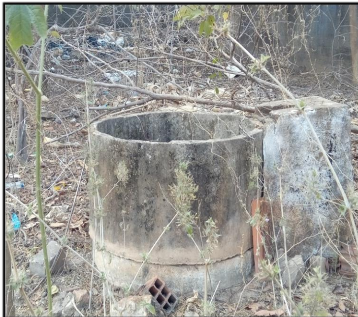
Figura 26: Fotografia de um poço abandonado sem nenhum tipo de proteção.
