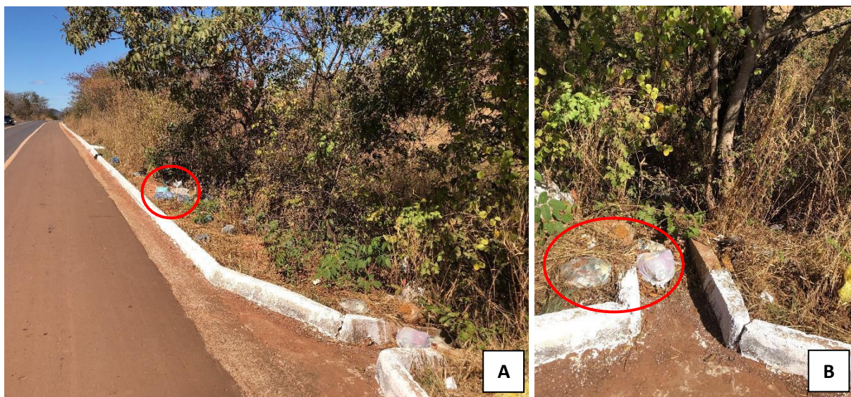
Figura 6. Valeta de escoamento de águas pluviais da BR-135 direcionada diretamente para a área de localização dos resíduos.
