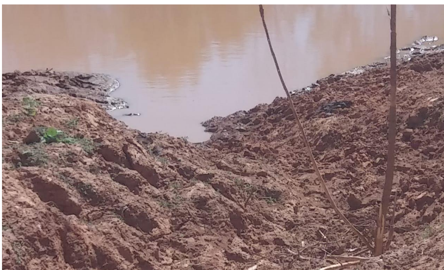
Figura 6- Assoreamento da barragem de Cocos
