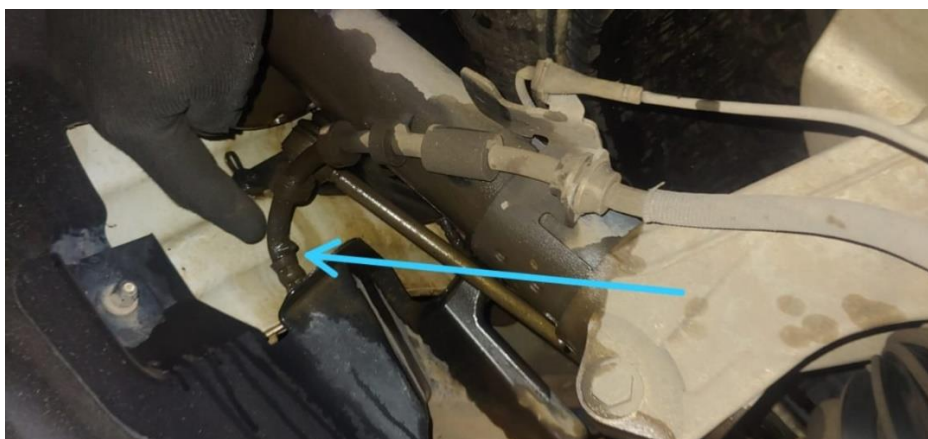
Figura 30 – Indicação do local de um vazamento através do tubo flexível
