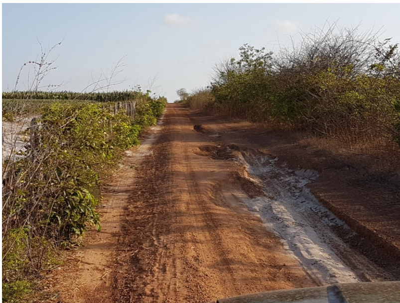
Figura 12- Trecho da estrada erodido no Perímetro irrigado. Ponto correspondente às coordenadas 03°00'53.18"S/41°45'49.87"O.
