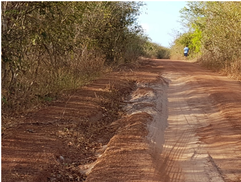
Figura 10- Trecho da estrada erodido no Perímetro irrigado. Ponto correspondente às coordenadas 03°00'17,02''S/41°43'56.87''O.
