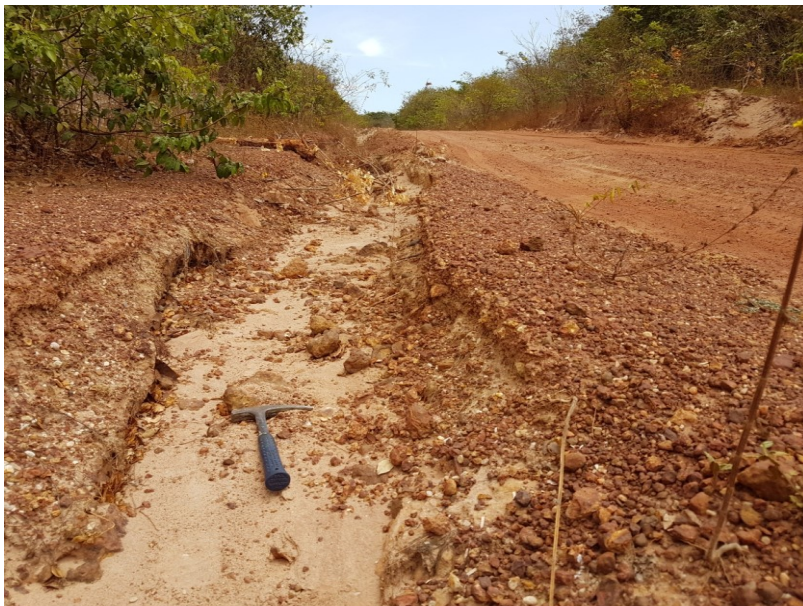
Figura 16- Trecho da estrada que dá acesso a lagoa do Portinho à Br 402 erodido, ponto logo abaixo do ponto da figura 14.
