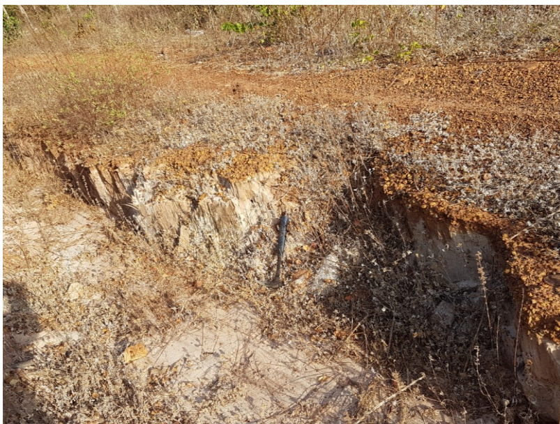
Figura 11- Trecho da estrada erodido no Perímetro irrigado. Ponto correspondente às coordenadas 03°00'07.78''S/ 41°45'19,59''O.
