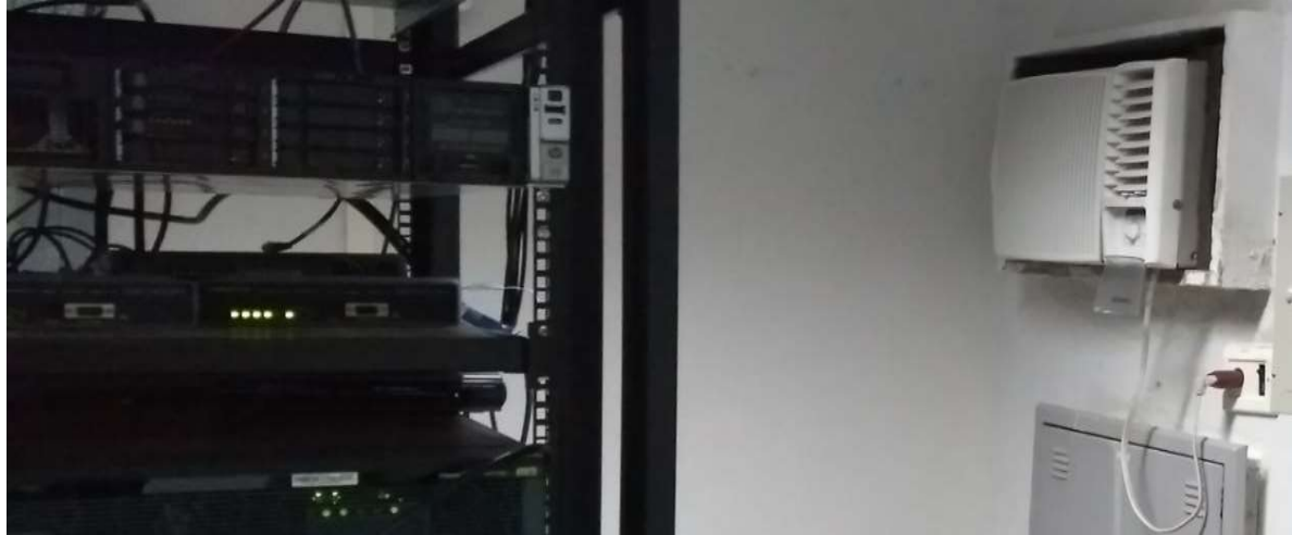
Figura 21: ar-condicionado tipo “janela” de 12 mil BTUs
