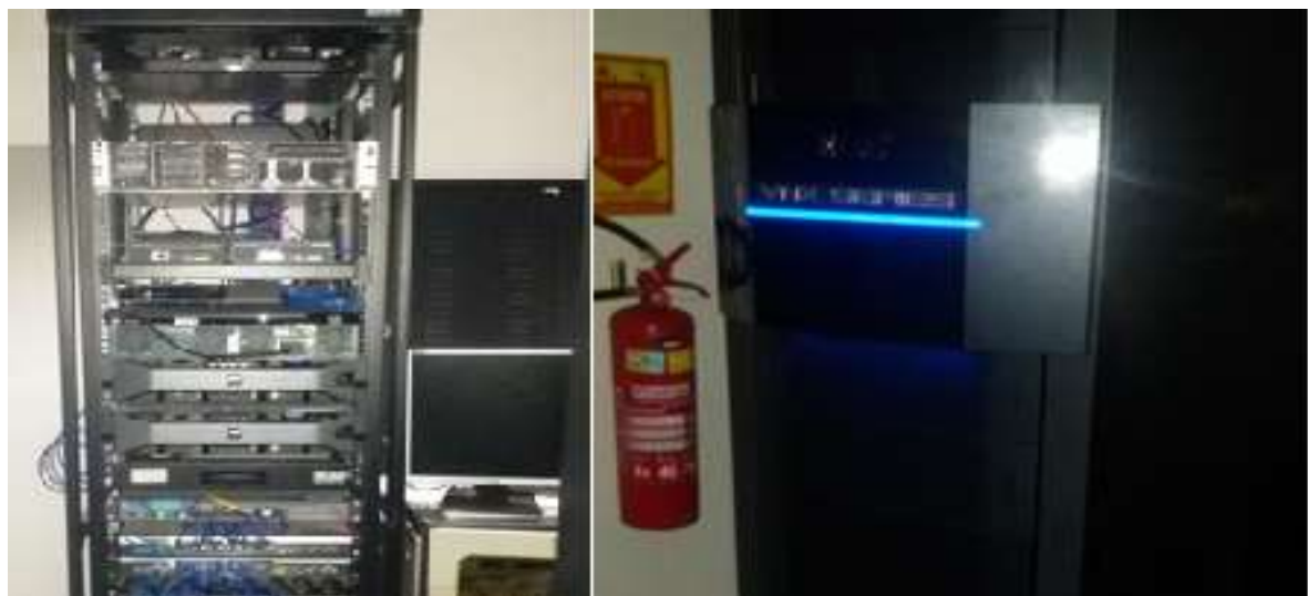
Figura 22: sala de servidores e o extintor de incêndio
