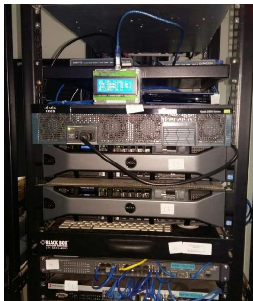
Figura 43 – protótipo instalado no rack
