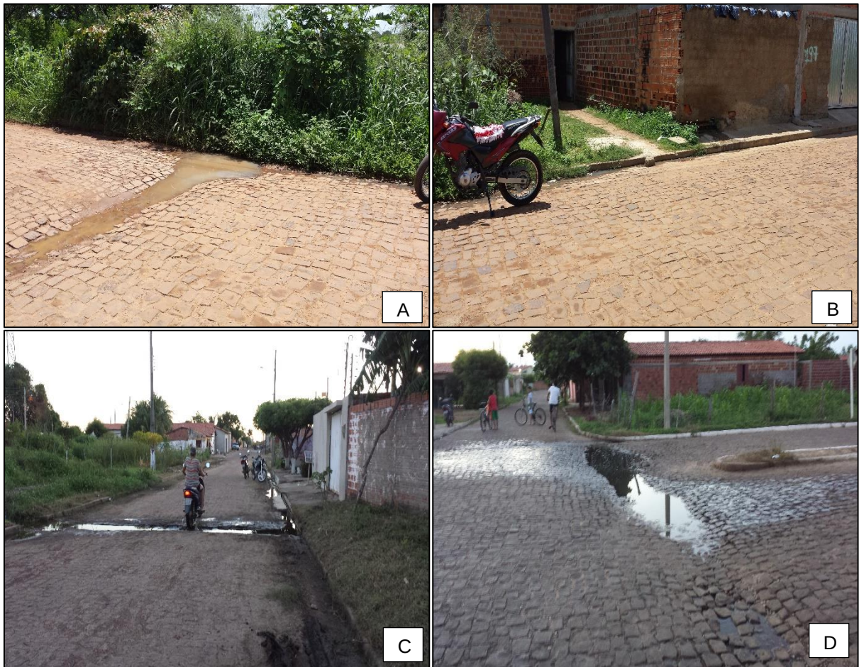
Figura 7 – Esgotos residenciais direcionados a rede de drenagem pluvial do bairro, o que acaba por ter sua deposição na lagoa. A- Esgoto depositado na rede de drenagem do bairro, B- procedência do esgoto, C e D- esgotos domésticos em ruas diferentes
