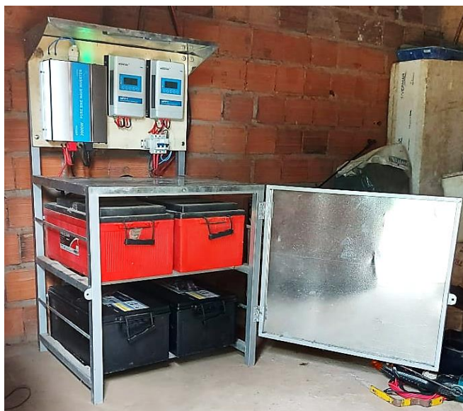
Figura 5 - Estrutura interna da residência com os equipamentos.
