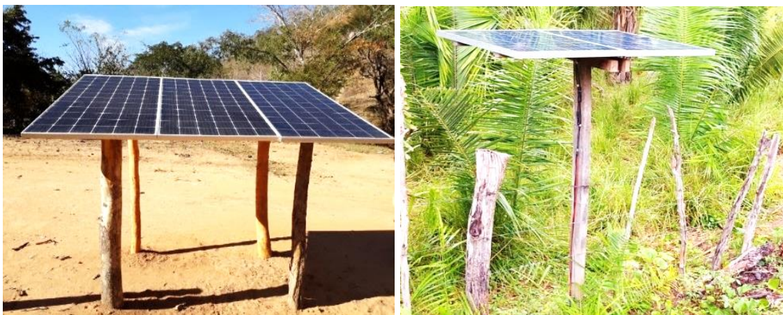
Figura 4 - Estrutura de madeira utilizadas como suporte das placas solares.
