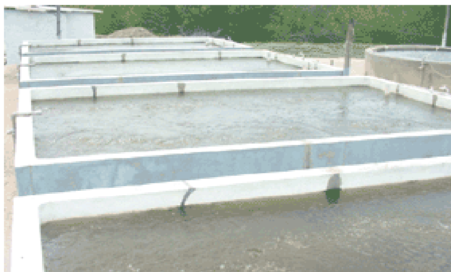
Figura 19: Tanque berçário de concreto retangular
