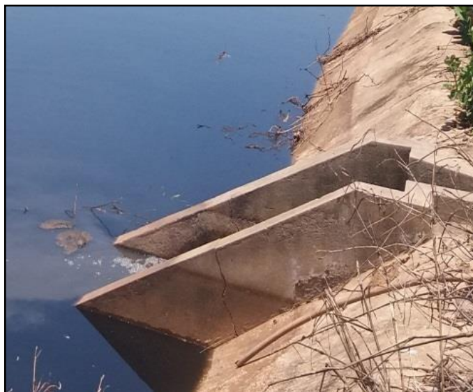
Figura 6- Canal de chegada dos resíduos na primeira lagoa.
