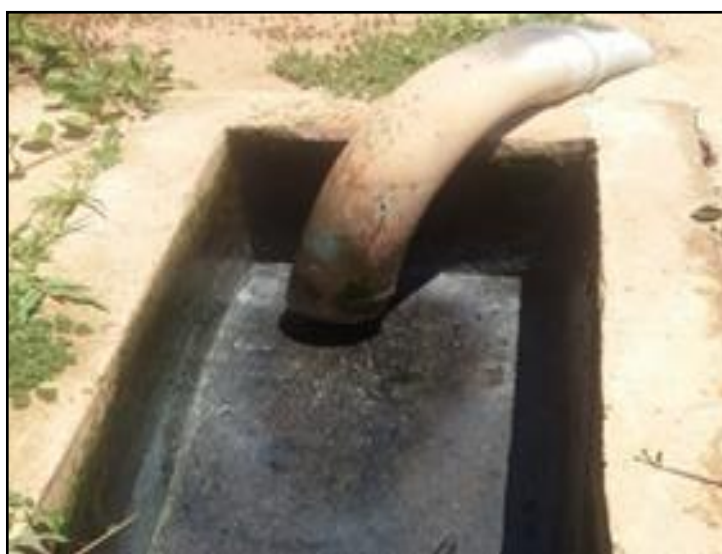
Figura 4 – Canal de condução do esgoto para a lagoa de estabilização. Fonte: levantamento de campo (2016)
