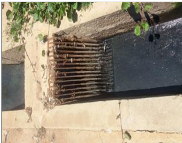
Figura 5 – Canal para retirada de material grosseiro.
