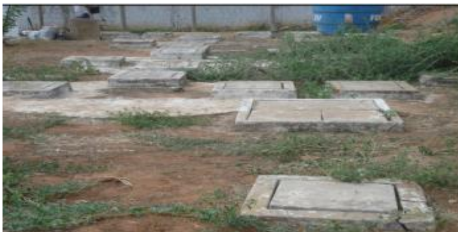
Figura 2 – Sistema de tanque séptico seguido de Filtro anaeróbico
