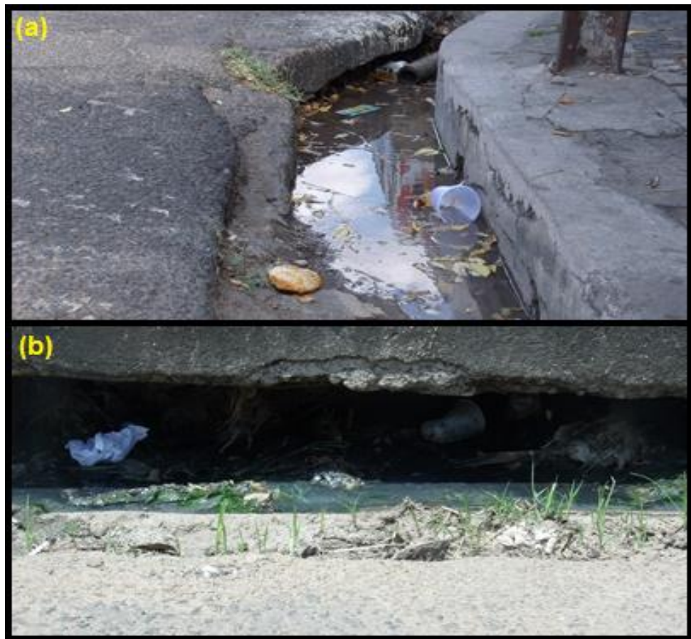
FIGURA 7- ACÚMULO DE RESÍDUOS NO SISTEMA DE DRENAGEM
