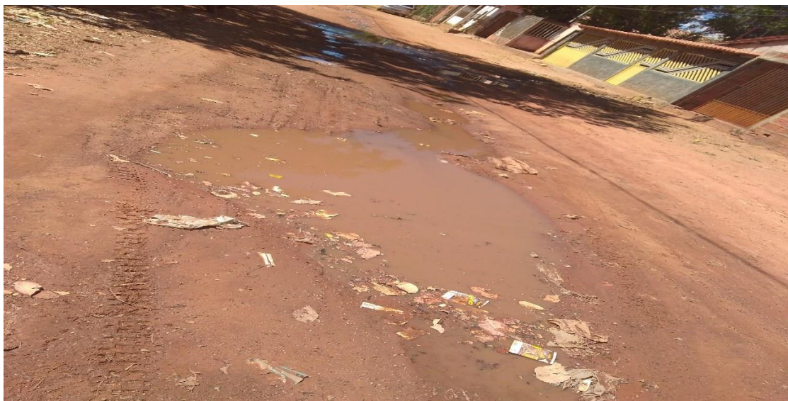
Figura 4 – locais com alagamentos. Fonte: Produção original, 2018.
