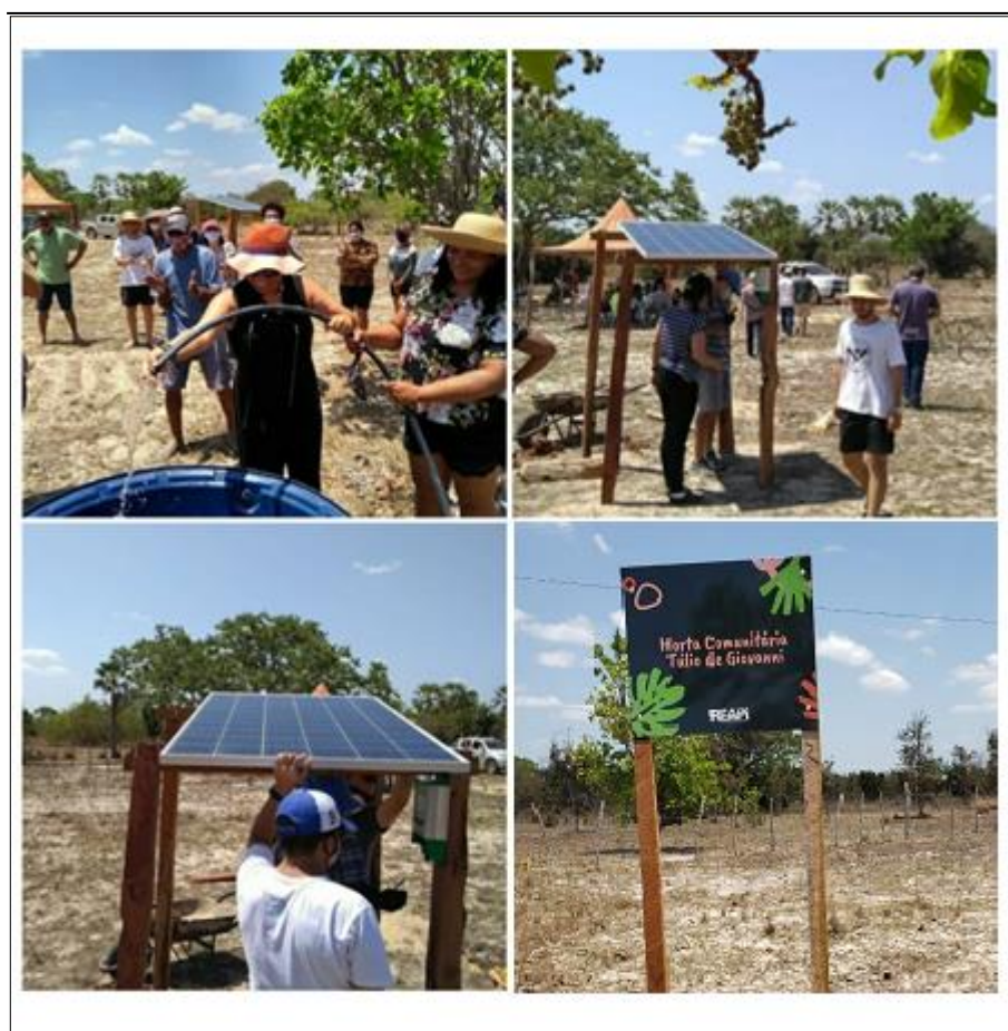
Figura 16 - Implantação do sistema de bombeamento fotovoltaico no Assentamento Marcos em José de Freitas-PI
