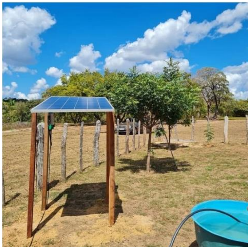
Figura 1 – Sistema de bombeamento solar no semiárido piauiense na Comunidade Barbosa em José de Freitas-PI - 2021
