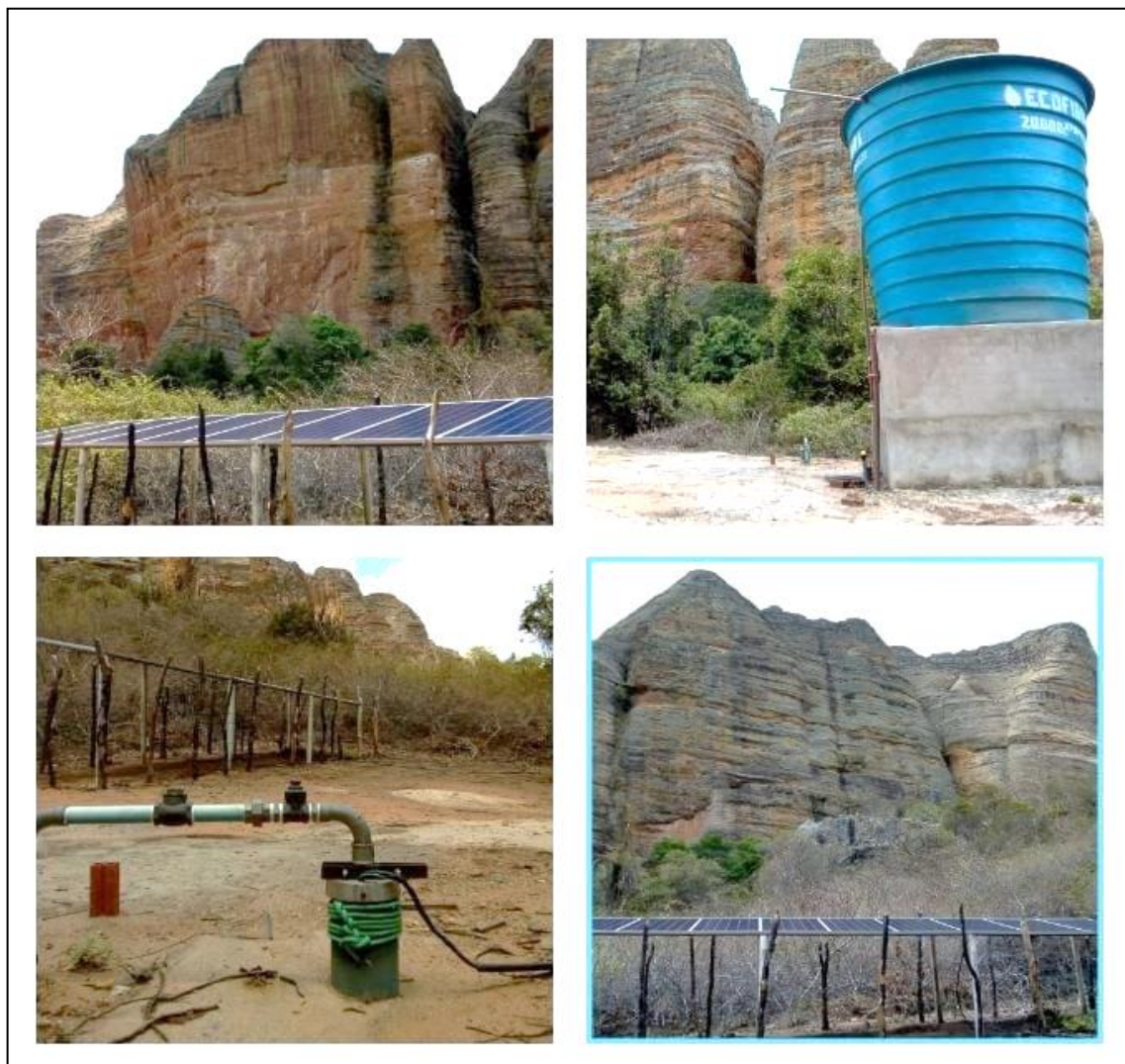
Figura 31 - Segundo sistema fotovoltaico de bombeamento em Barreirinho, no município de Coronel José Dias -PI
