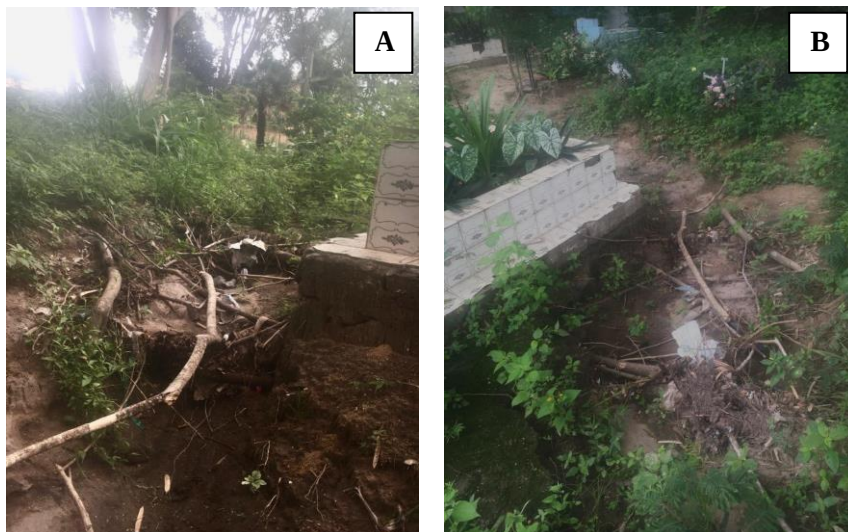
Figura 23. A e B - Sulcos erosivos no Cemitérios Areias, Zona Sul, Teresina
