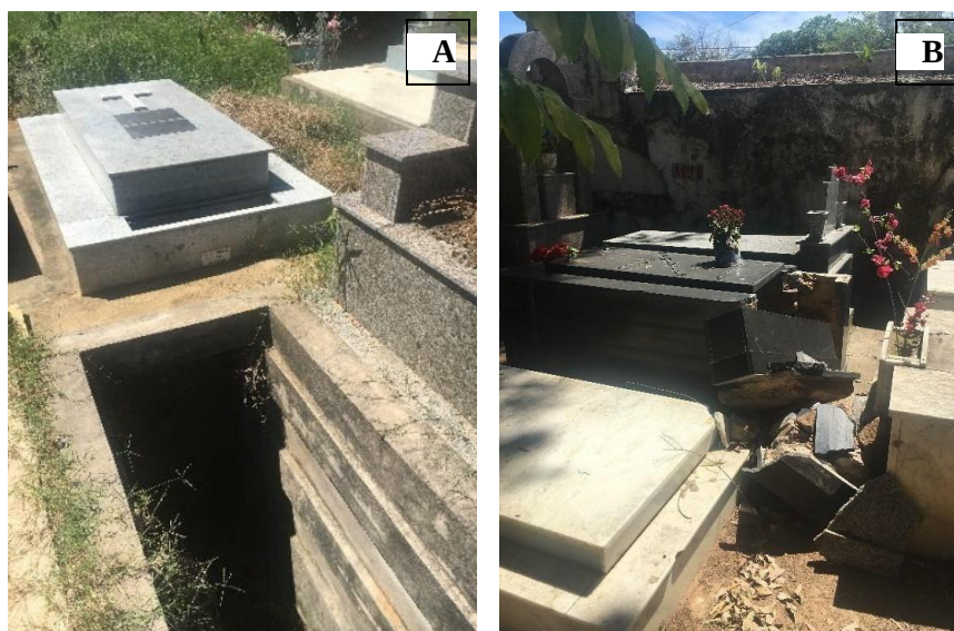
Figura 36. A - Jazigos abertos no cemitério São José; B – Jazigos com estrutura danificada Zona Central, Teresina.
