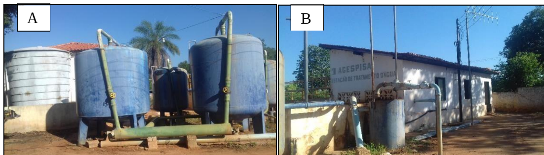
Figura 2 A e B: Estação de tratamento de água do município. Fonte: do autor 2016.
