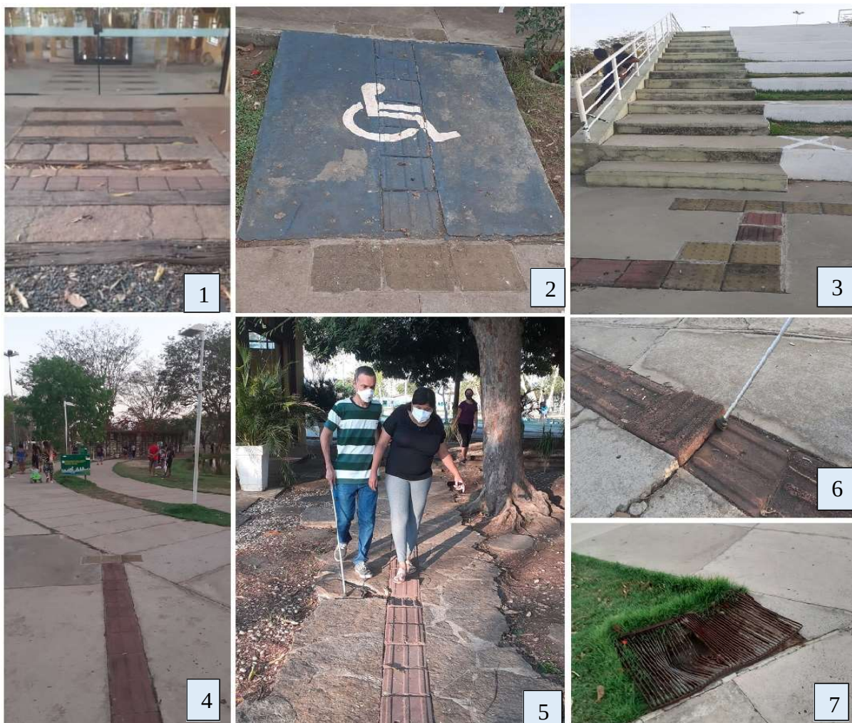
Figura 19 - Infraestrutura irregular de acessibilidade ambiental - Parque da Cidadania - Teresina-PI
