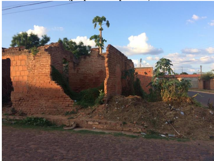
Figura 6: Construção em ruínas situada à Rua Numas Pompílio (propriedade privada)
