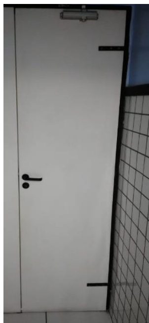
Figura 19: local sem a presença do símbolo internacional de radiação.
