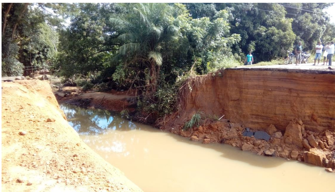
Figura 43: Foto ilustrando ponto de rompimento da BR 343.
