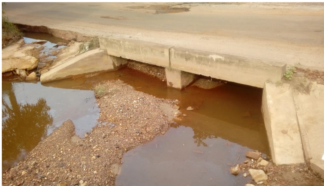
Figura 37: Foto do bueiro parcialmente entupido.
