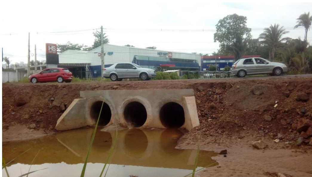
Figura 27: Ponto com vulnerabilidade a alagamento na BR 343.
