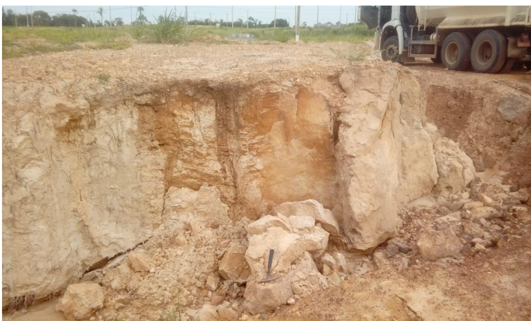
Figura 38: Foto demonstrativa da erosão no condomínio Villa Imperial.
