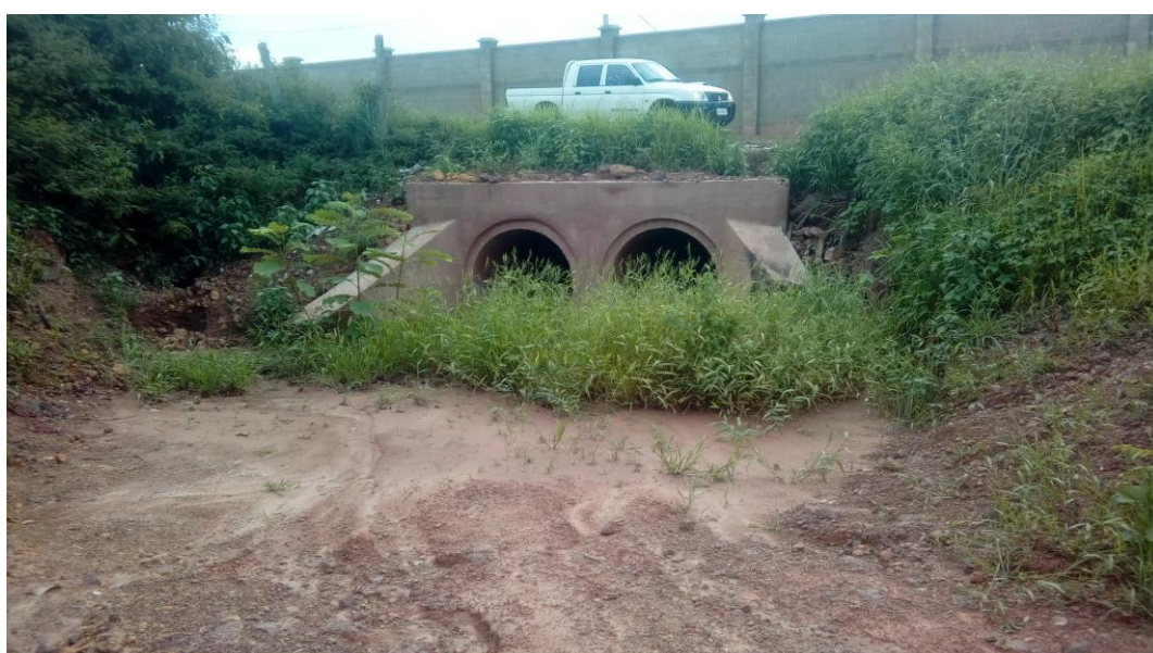
Figura 31: Foto do bueiro encontrado no condomínio ALDEBARAM LESTE.
