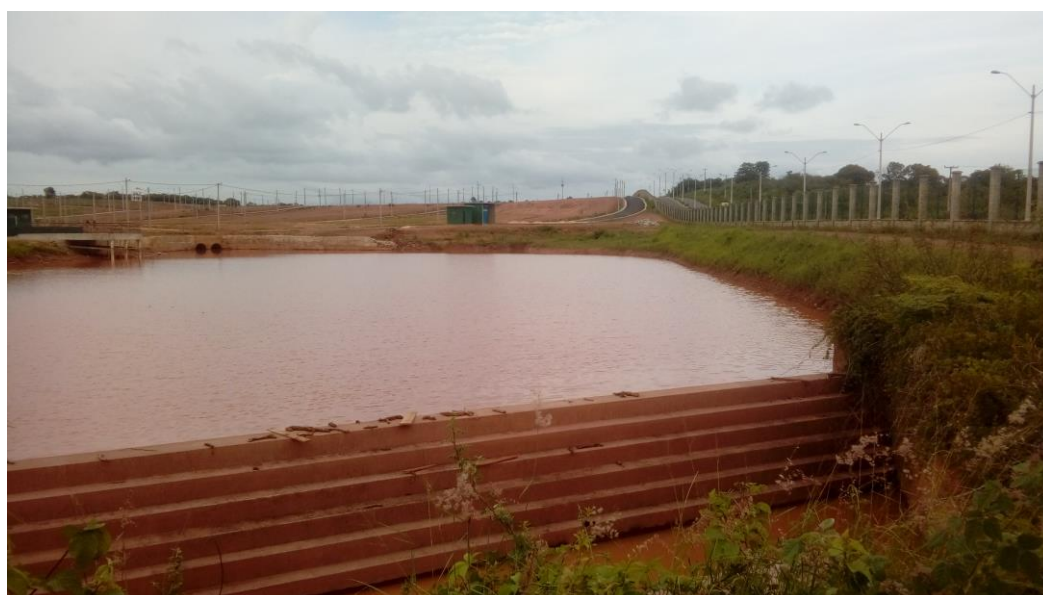
Figura 32: Foto da lagoa de retenção/detenção do condomínio ALDEBARAM LESTE.
