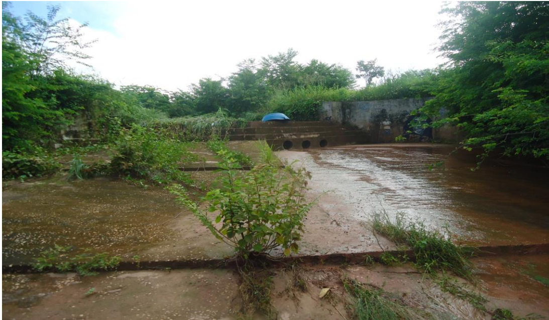
Figura 34: Sistema de contenção / detenção de água.
