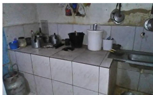
Figura 18 – Fogão à brasa colado na parede
