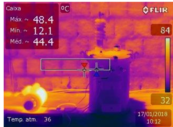
Figura 21: Imagem termica do transformador
