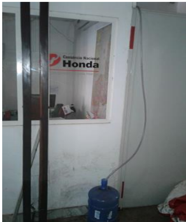
Figura 02. Coleta de água ar Condicionado
