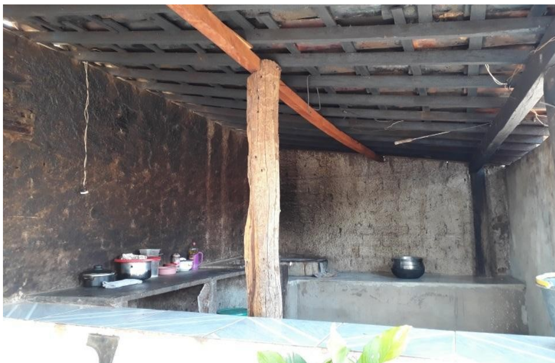
Figura 10 -Telhado e paredes sujos pela fumaça
