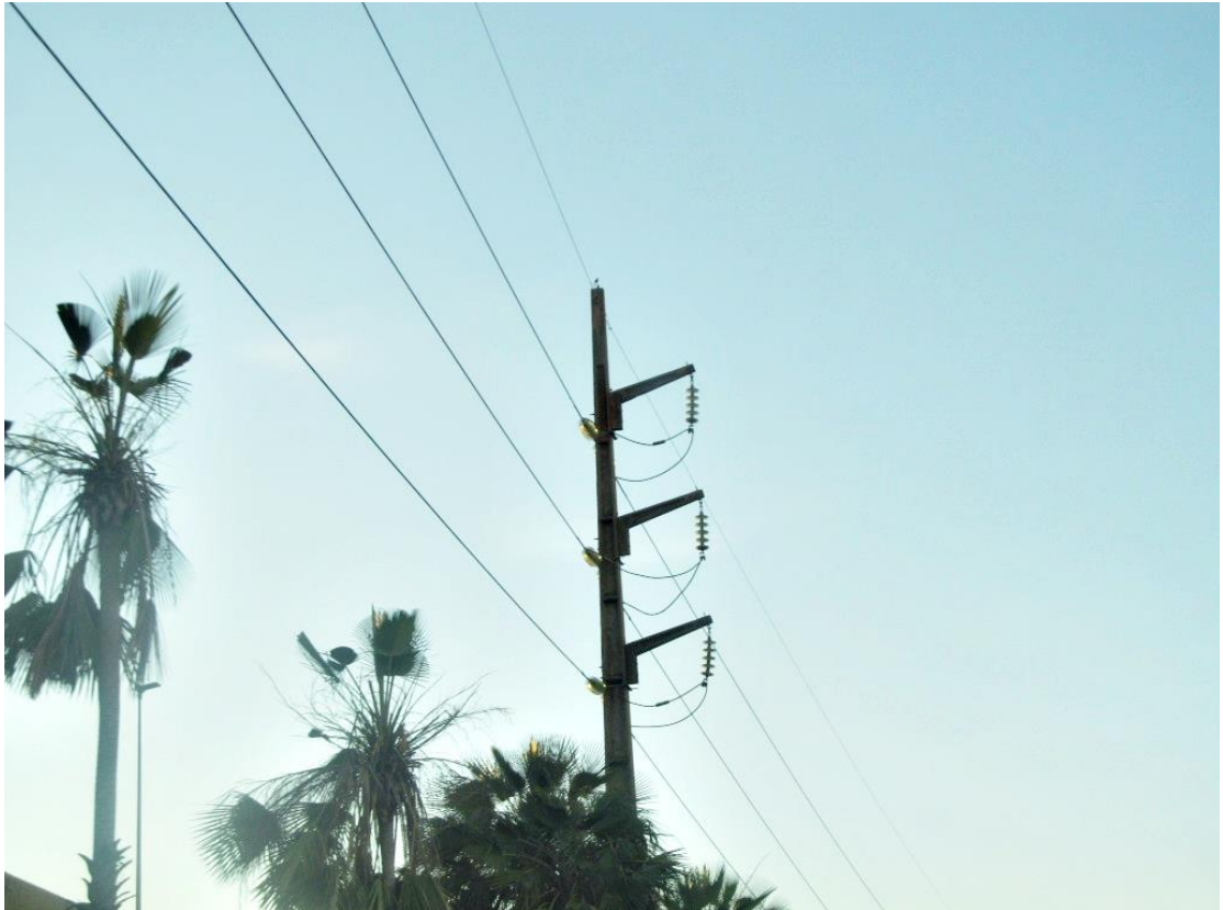
Fotografia 3 – Rede de Alta Tensão na Avenida Maranhão
