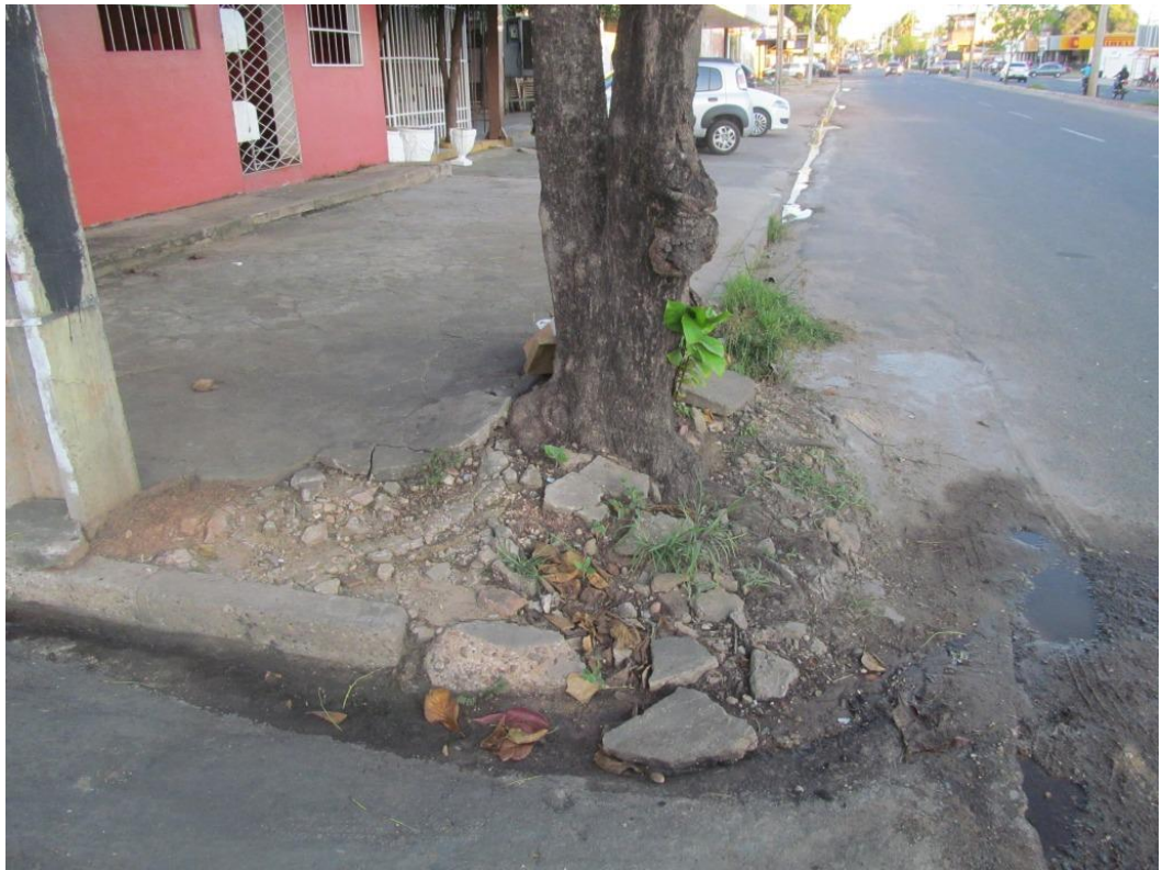
Fotografia 6 – Tronco e raízes de Amendoeira ( Terminalia catappa ) conflitando com a calçada na Avenida Barão de Gurguéia
