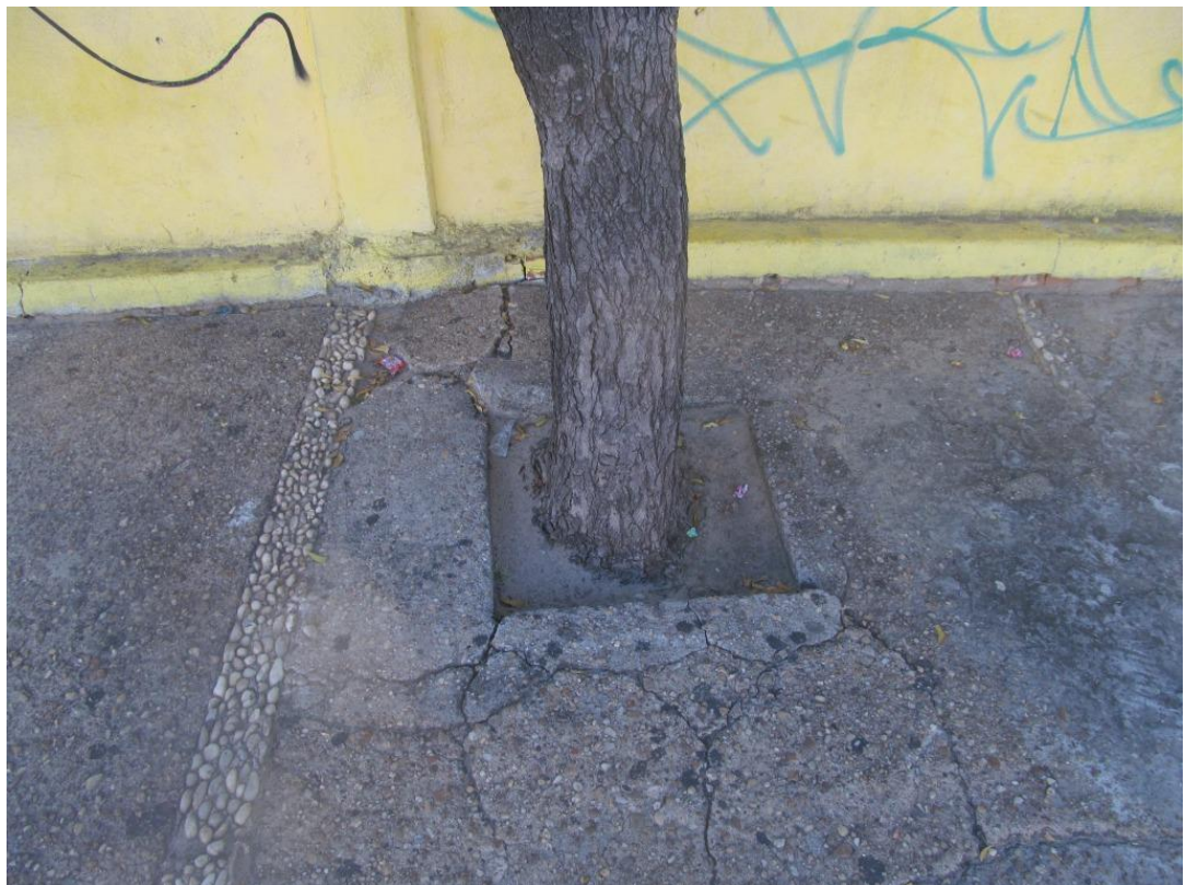
Fotografia 8 – Calçada da Avenida Barão de Gurguéia quebrada pela raiz superficial de um Neem ( Azadirachta indica )
