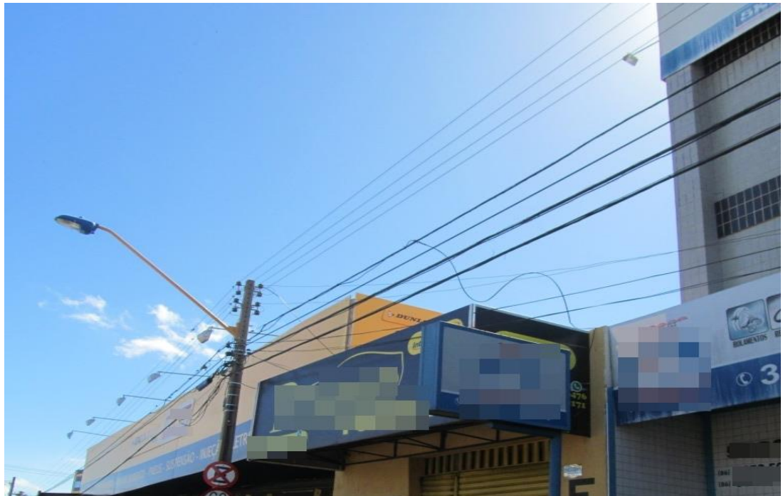
Fotografia 1 – Redes de Baixa e Média Tensão na Avenida Miguel Rosa.
