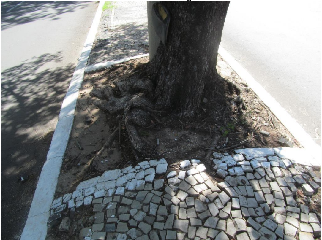
Fotografia 9 – Conflito das raízes do Oitizeiro ( Licania tomentosa ) no canteiro central da Avenida Miguel Rosa
