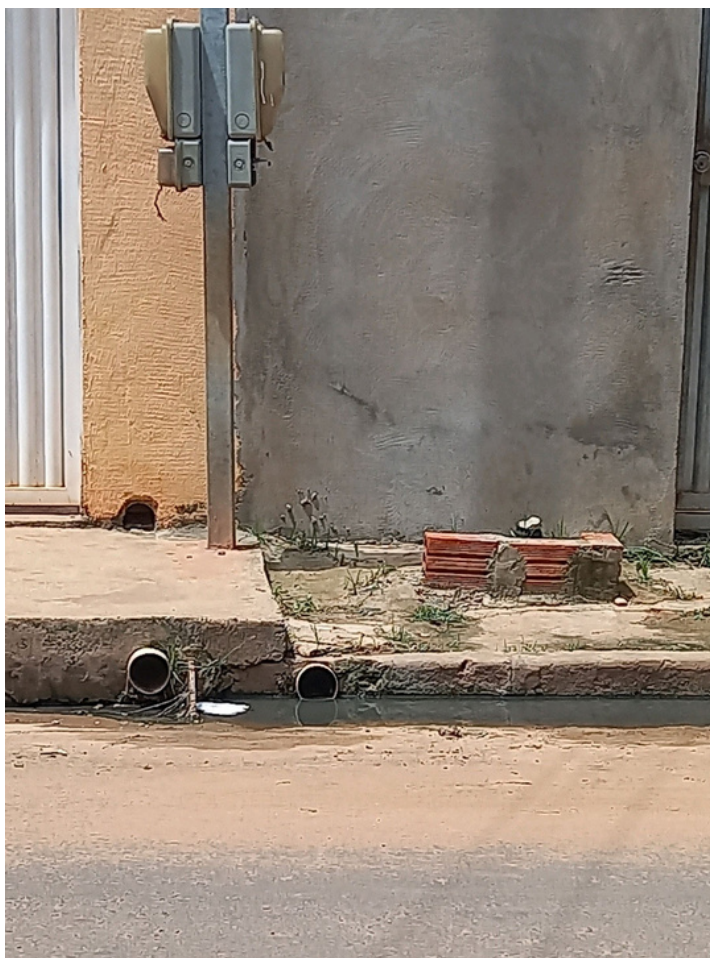
Figura 7 - Casa com presença de caixa de hidrômetro e com esgotamento sanitário lançado em vias públicas no conjunto Novo Joia. Fonte: dados da pesquisa (2023).
