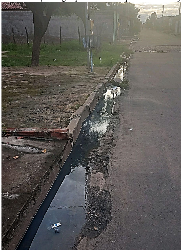
Figura 23: Presença de água parada nas vias públicas dos conjuntos.
