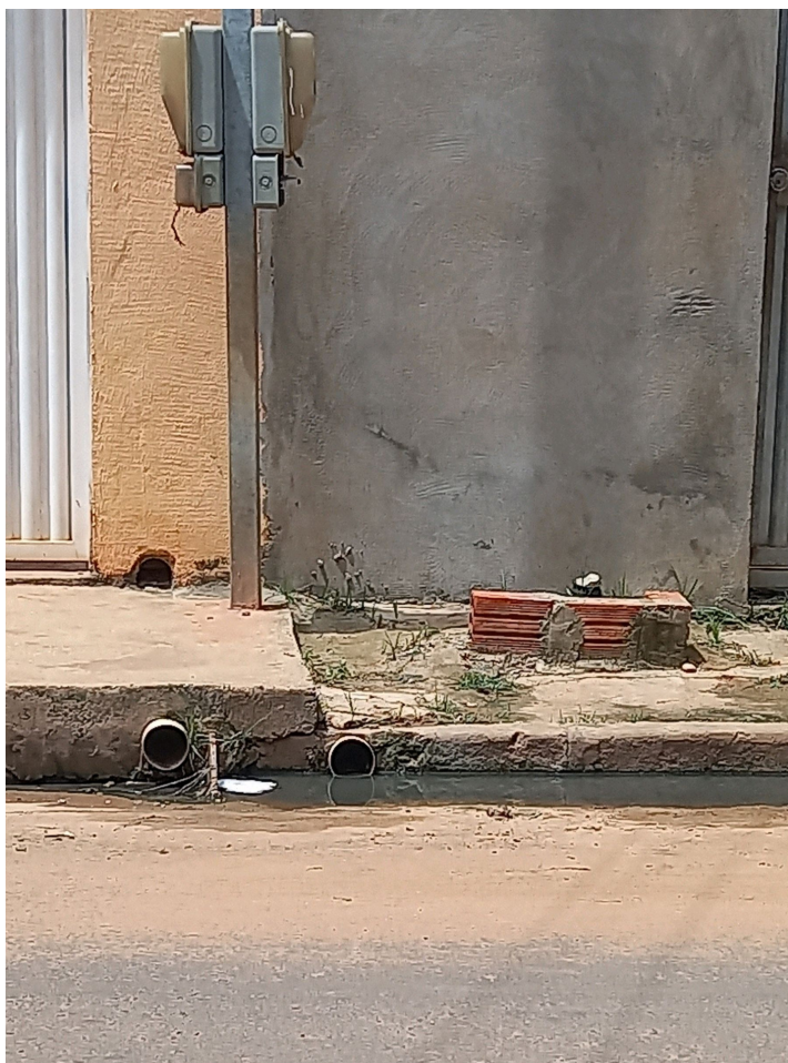
Figura 5 - Casa com presença de caixa de hidrômetro e com esgotamento sanitário lançado em vias públicas no conjunto Novo Joia.
