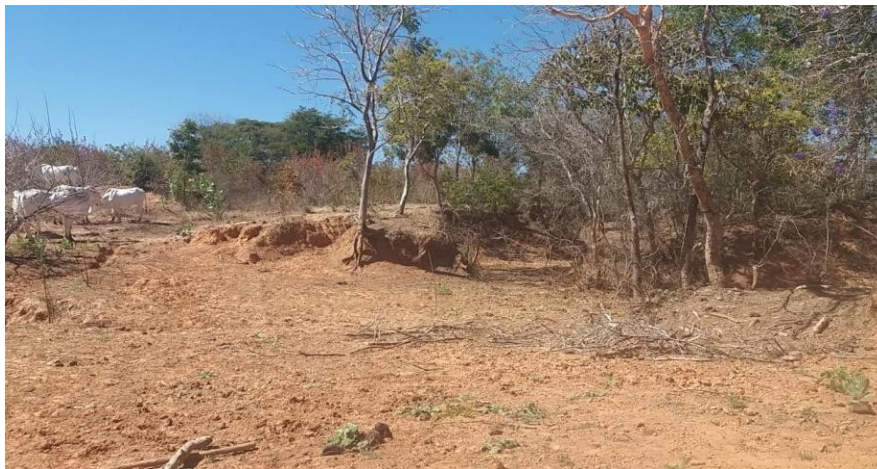
Figura 5. Perda da vegetação da barragem de Cocos
