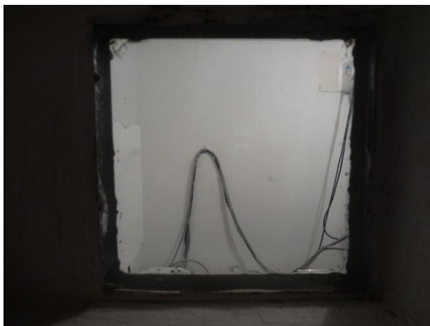
Figura 15 – Vista do visor plumbífero da sala E.
