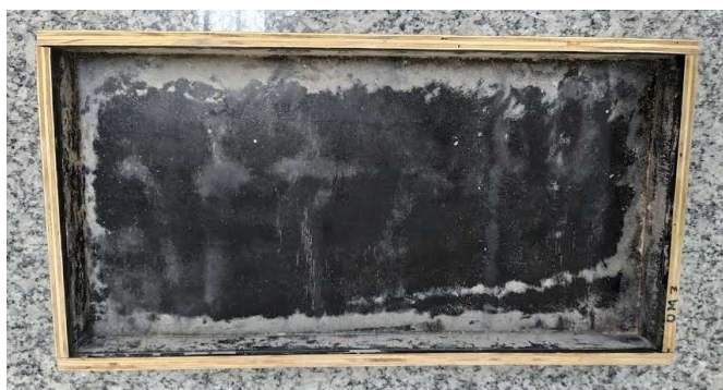
Figura 29 – Estado da superfície da forma após aplicação do OM.
