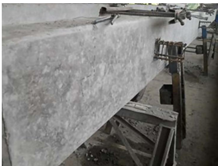
Figura 01 – Manchas na superfície de concreto do elemento.
