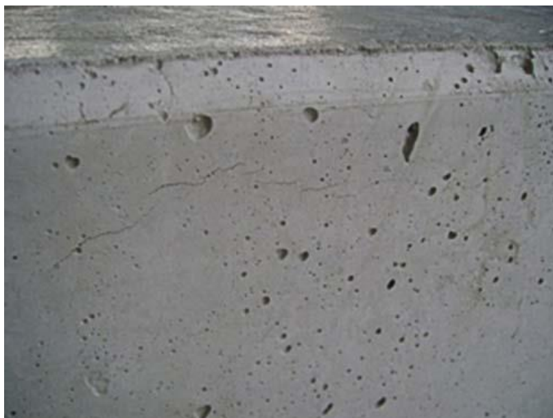
Figura 02 – Bolhas na superfície do elemento de concreto.
