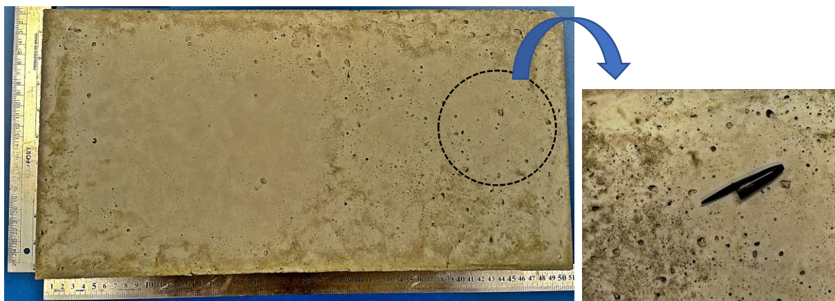
Figura 24 – Aspecto superficial do elemento de concreto com aplicação do OB.
