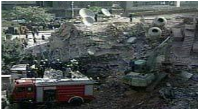
Figura 10 – Colapso total da Biblioteca Municipal de Linköping – Suécia, 1996
