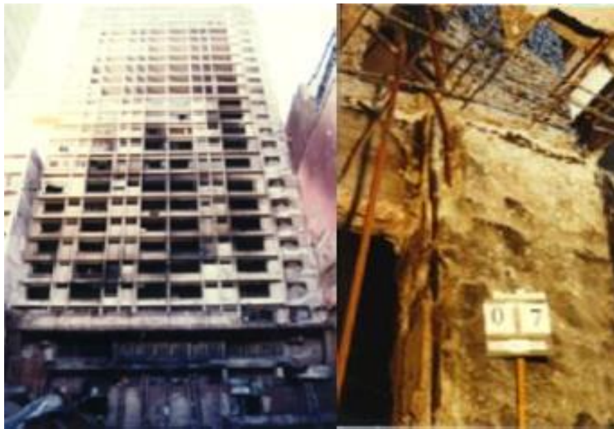
Figura 15 – Colapso parcial do edifício Sede II da CESP em São Paulo – Brasil, 1987
