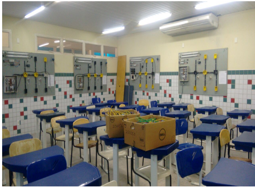
Figura 4: Laboratório de instalações elétricas
