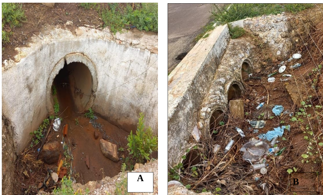
Figura 04 - Bocas-de-lobo com resíduos sólidos impedindo a drenagem eficiente das águas pluviais.
