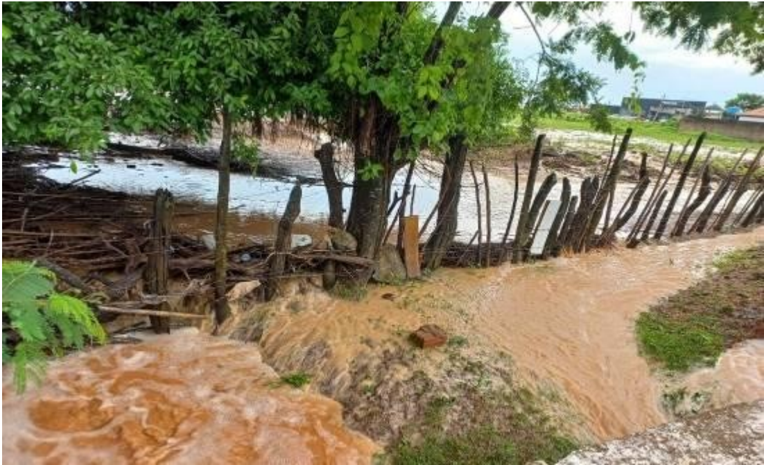
Figura 05 - Criatório de caprinos do bairro, próximo ao sistema de drenagem boca-de-lobo
