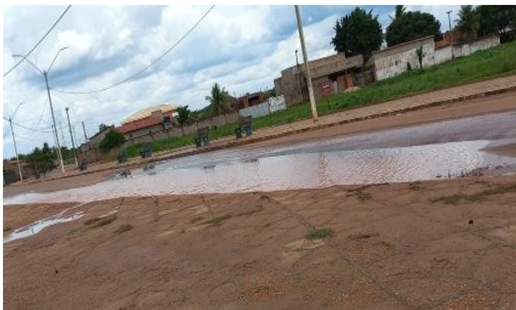
Figura 06 - Registro de acúmulo de água em avenida do bairro Nova Corrente
