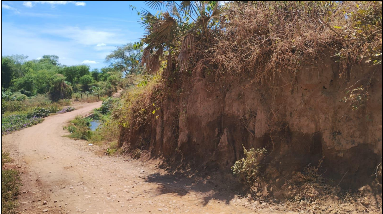
Figura 11 - Erosão de APP do Rio Piauí no trecho urbano de São João do Piauí.
