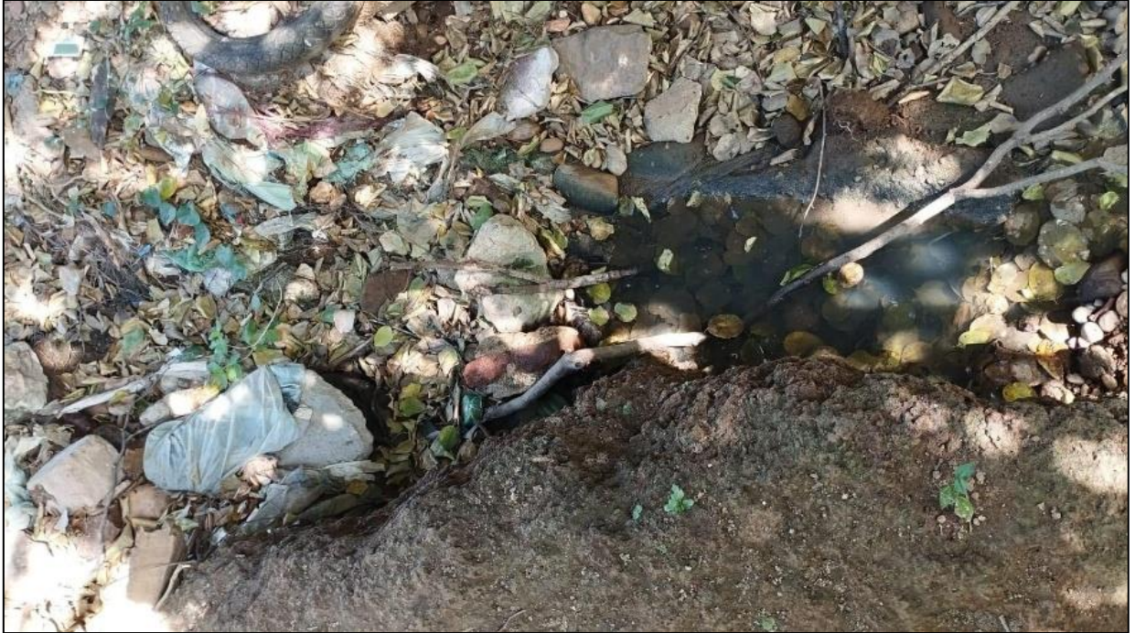
Figura 6 - Presença de lixo e esgoto a céu aberto na área de APP do Rio Piauí no trecho urbano de São João do Piauí.
