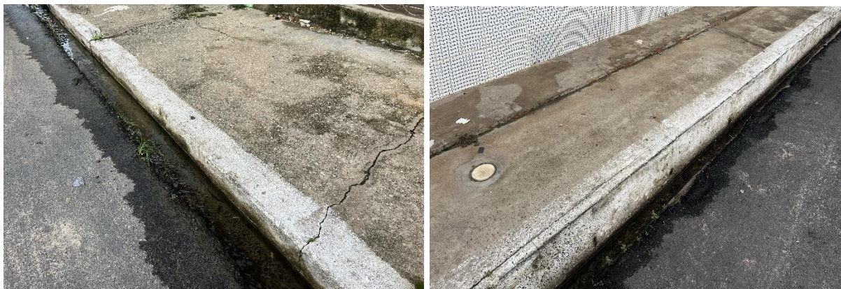
Figura 35 – Esgoto a céu aberto no Setor 1
