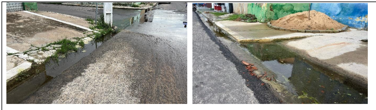
Figura 36 - Esgoto a céu aberto no setor 32
