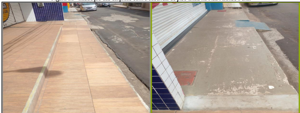
Figura 21 - Ilustração das calçadas com a ausência de piso táteis na Rua Afonso Pena.
