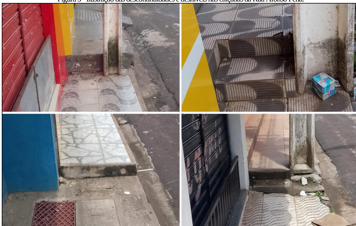
Figura 5 - Ilustração das discontinuidades e desníveis nas calçadas da Rua Afonso Pena.
