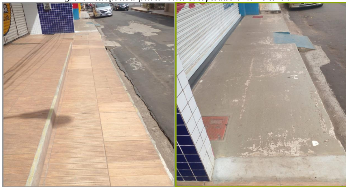
Figura 10 - Ilustração das calçadas com a ausência de piso táteis na Rua Afonso Pena.
