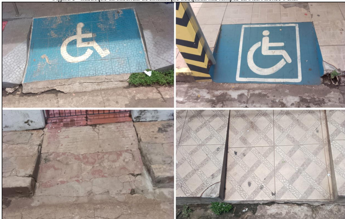
Figura 8 - Ilustração da ausência de sinalização adequada nas rampas da Rua Afonso Pena.
