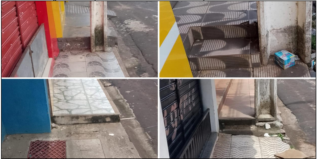
Figura 16 – Ilustração das descontinuidades e desníveis nas calçadas da Rua Afonso Pena.
