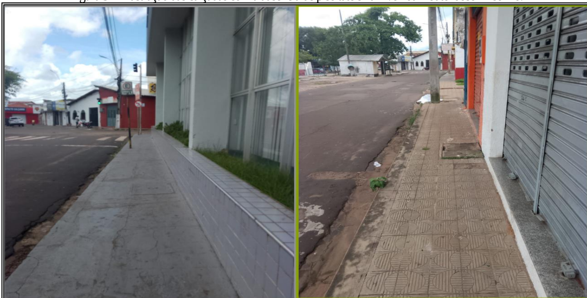
Figura 37 - Ilustração das calçadas com a ausência de piso táteis na Avenida Doutor José Anselmo.
