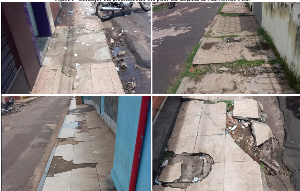
Figura 9 - Ilustração das problemáticas dos pisos das calçadas da Rua Afonso Pena.
