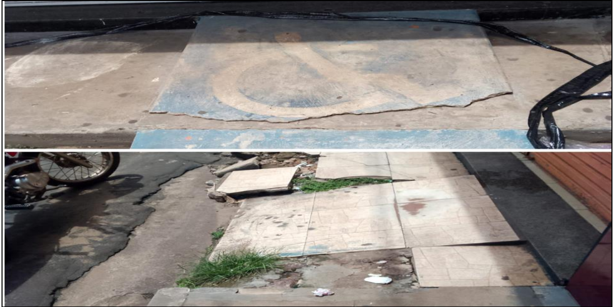
Figura 18 - Ilustração da má qualidade estrutural das rampas na Rua Afonso Pena.
