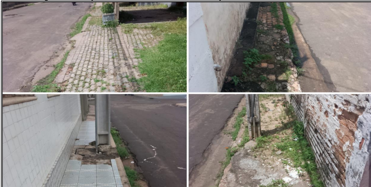
Figura 36 - Ilustração das discontinuidades e desníveis nas calçadas da Avenida Doutor José Anselmo.
