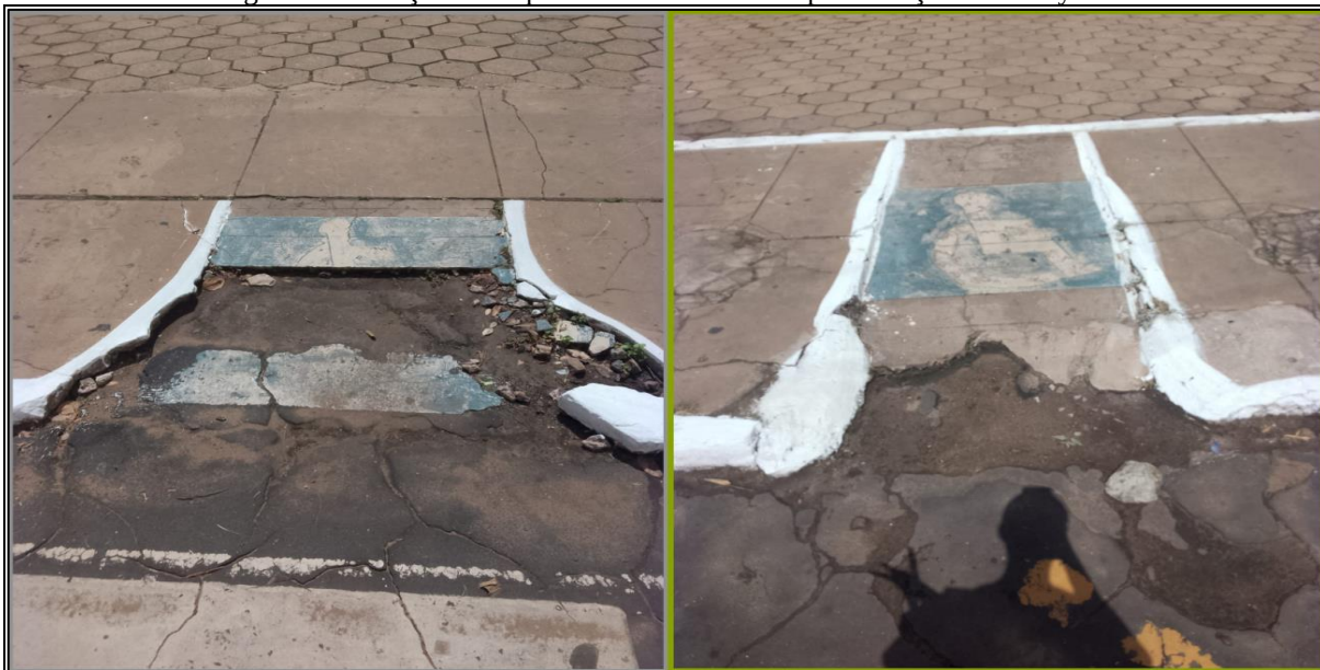
Figura 41 - Ilustração da má qualidade estrutural das rampas na Praça Ferreira Bayma.
