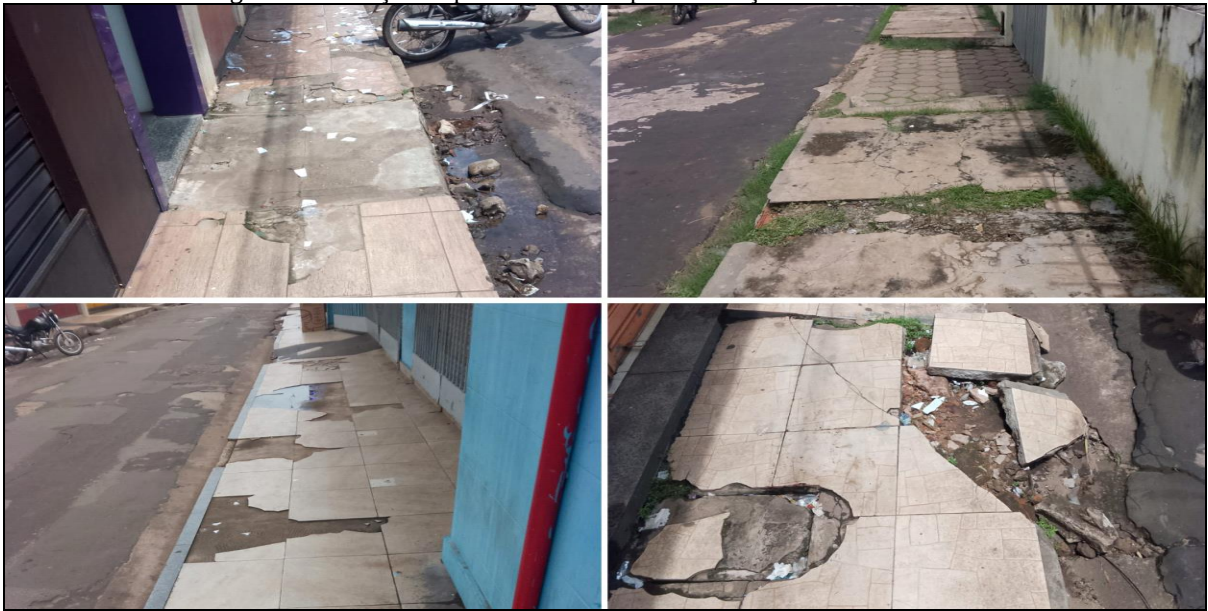
Figura 20 - Ilustração das problemáticas dos pisos das calçadas da Rua Afonso Pena.
