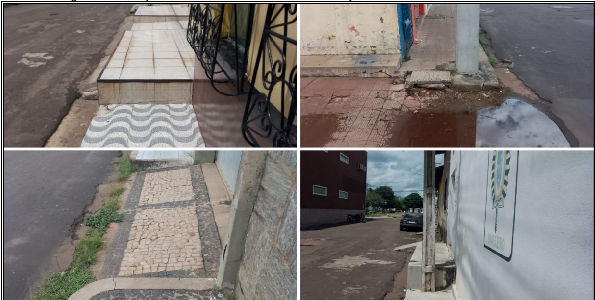
Figura 32 - Ilustração das descon continuidades e desníveis nas calçadas da Avenida Doutor José Anselmo.
