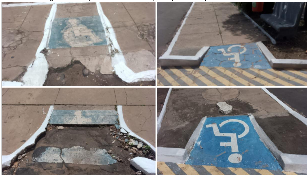
Figura 42 - Ilustração da ausência de sinalização adequada nas rampas da Rua Afonso Pena.
