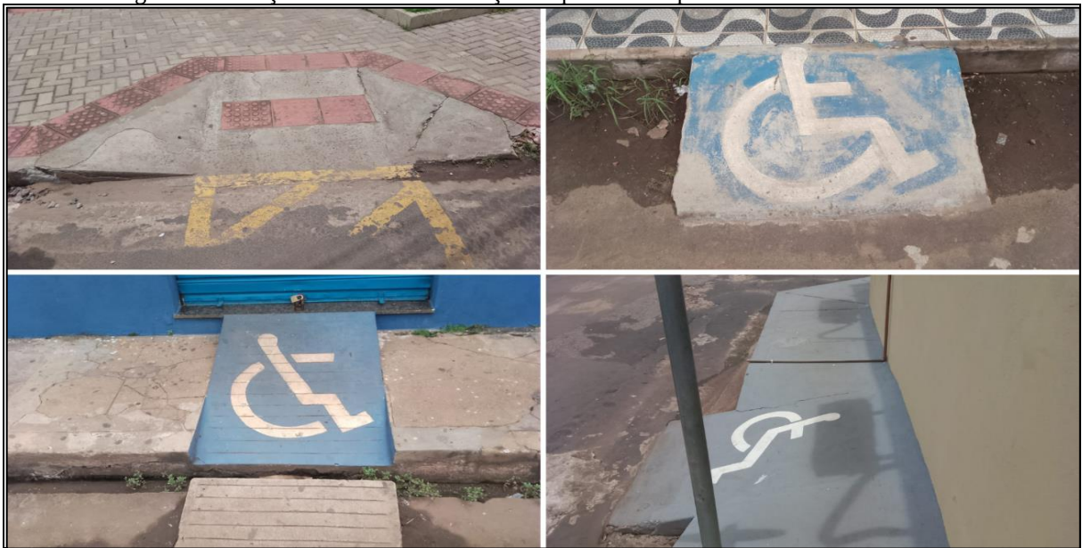
Figura 27 - Ilustração da ausência de sinalização adequada nas rampas da Rua Fernando de Carvalho.
