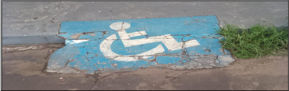
Figura 34 - Ilustração da má qualidade estrutural das rampas na Avenida Doutor José Anselmo.
