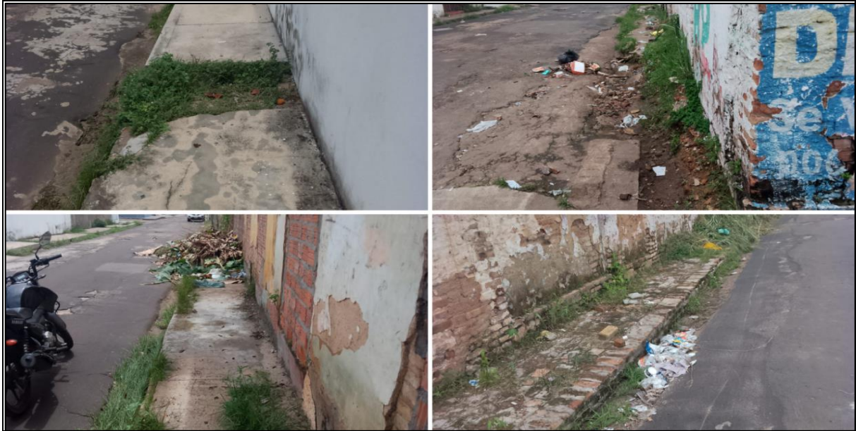
Figura 28 - Ilustração das problemáticas dos pisos das calçadas da Rua Fernando de Carvalho.
