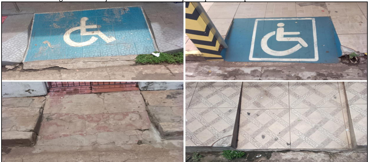
Figura 19 - Ilustração da ausência de sinalização adequada nas rampas da Rua Afonso Pena.
