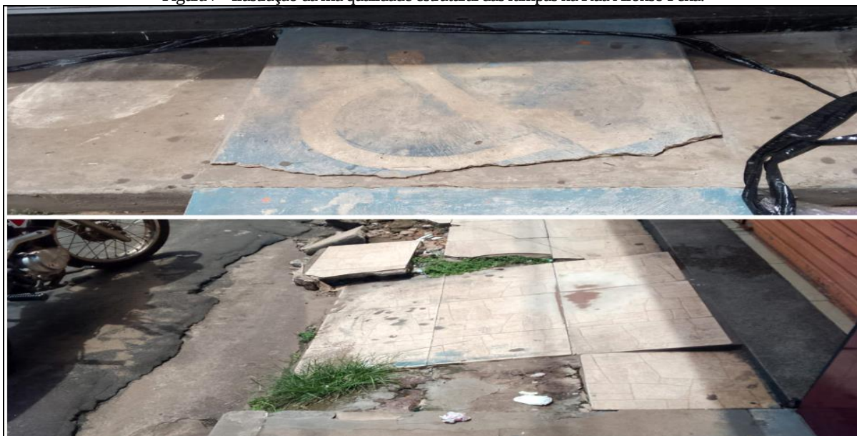
Figura 7 - Ilustração da má qualidade estrutural das rampas na Rua Afonso Pena.
