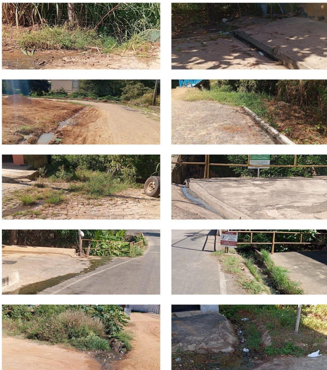
Figura 10: Identificação do despejo direto de esgotos no corpo do riacho Coroatá.
