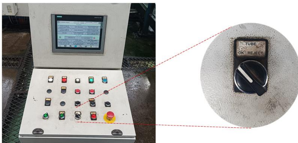
Figura 4 - Painel e chave de remoção de produto não conforme.
