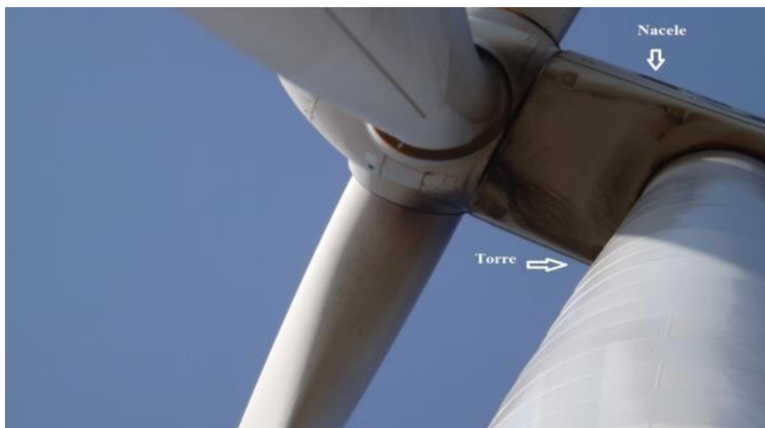
Foto 8 - Torre eólica com marcas de vazamento de óleo:
