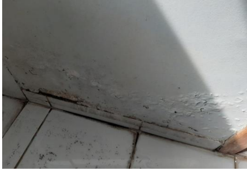
Figura 9 - Infiltração identificada no rodapé do banheiro
