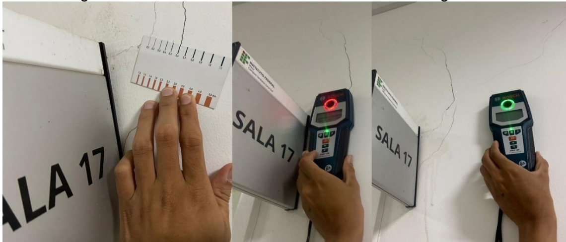
Figura 21 – Trincas nas salas de aula do bloco de engenharia
