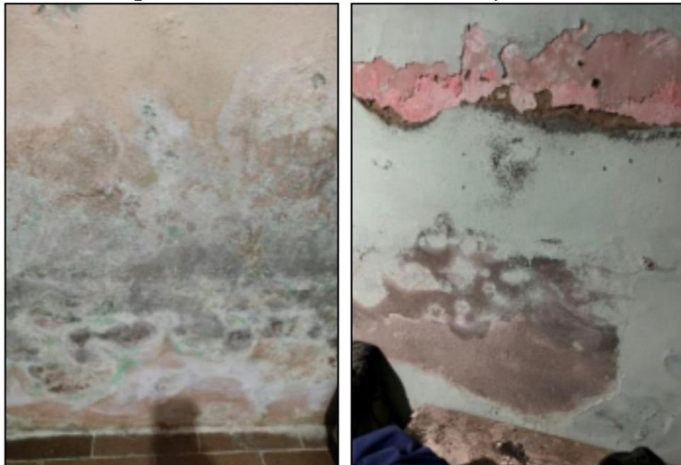
Figura 8 - Sinais de eflorescência em paredes
