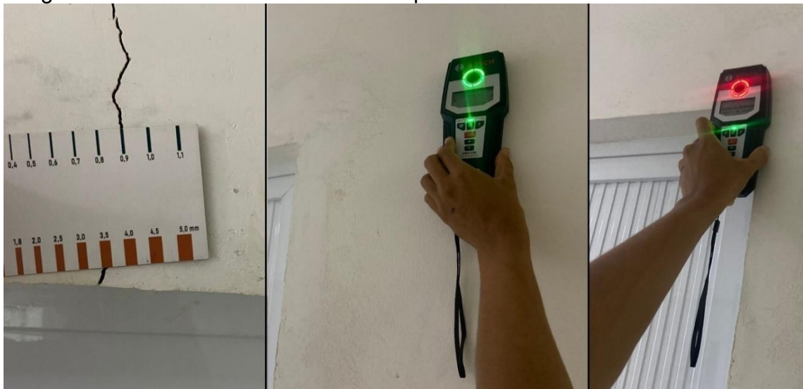
Figura 22 – Trincas no meio do vão na porta de duas folhas do Inova Maker.
