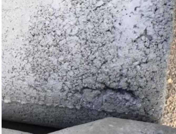
Figura 11 – Ninhos de concretagem em manilhas
