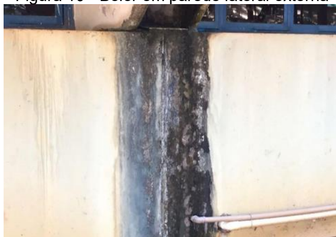
Figura 10 - Bolor em parede lateral externa
