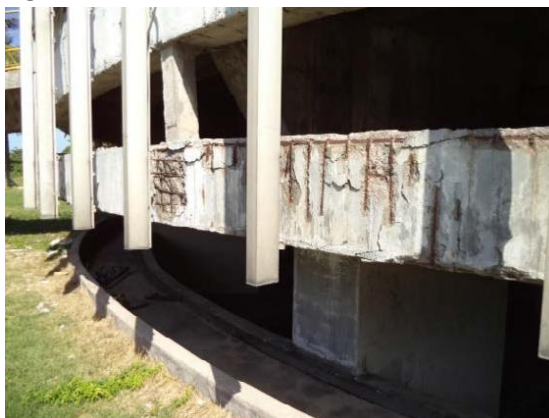
Figura 6 – Corrosão em um elemento de concreto armado.
