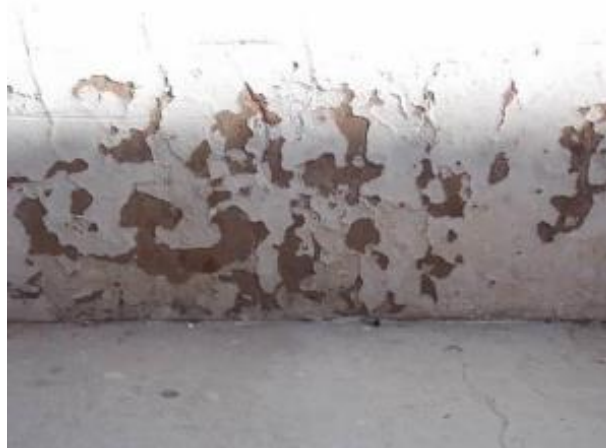
Figura 13 – Descascamento de pintura no muro
