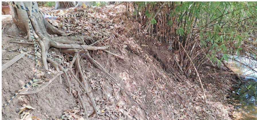
Figura 8 - Erosões no solo encontrado na margem do rio Parnaíba, localizado no Bar do Marzinho.
