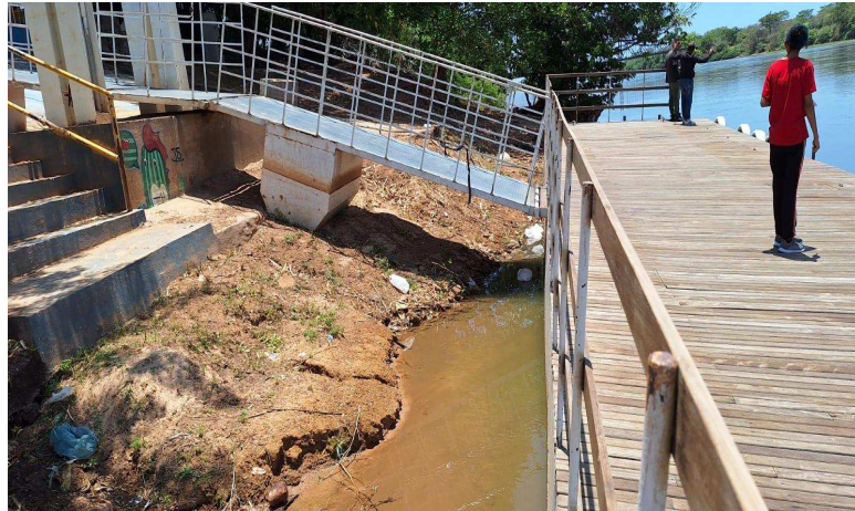
Figura 13 - Erosões no solo encontrado na margem do rio Parnaíba, localizado no ponto no The Pier Flutuante.
