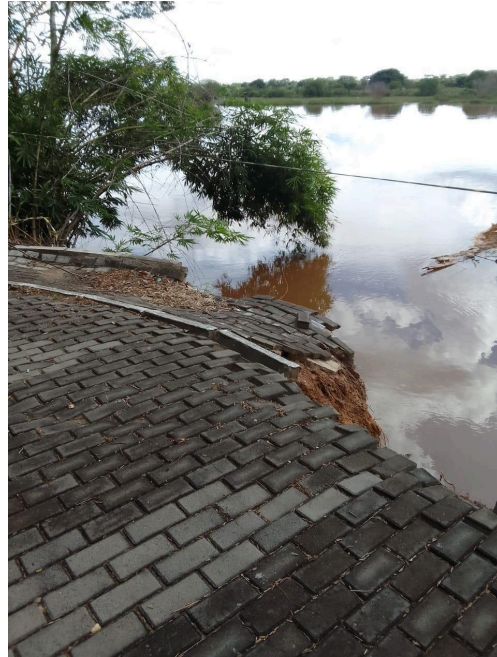
Figura 14 – Concreto quebrado no Parque Encontro dos Rios
