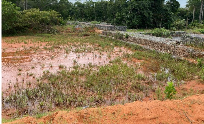
Figura 4. Bacias de contenção de água pluvial
