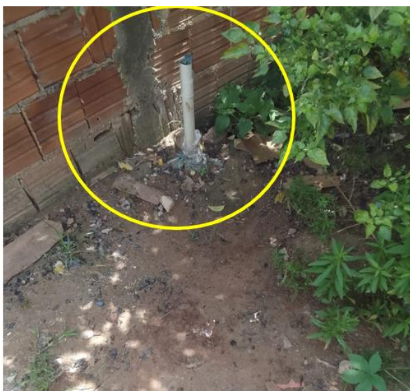
Figura 1 – Registro de fossa sem revestimento em proximidade de poço de água subterrânea, evidenciando potencial risco de contaminação.
