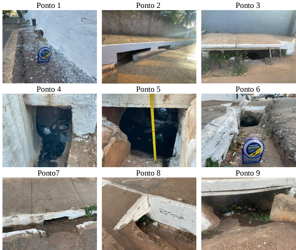
Figura 3- Condições estruturais das bocas de lobo
