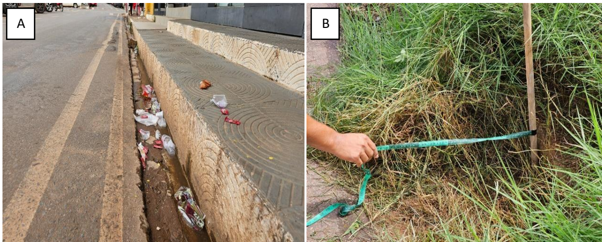
Fotografia 4 – Obstrução da sarjeta pelo acúmulo excessivo resíduos sólidos e vegetação
