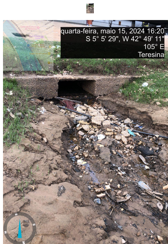
Figura 23 - Presença de resíduos em canal de drenagem.
