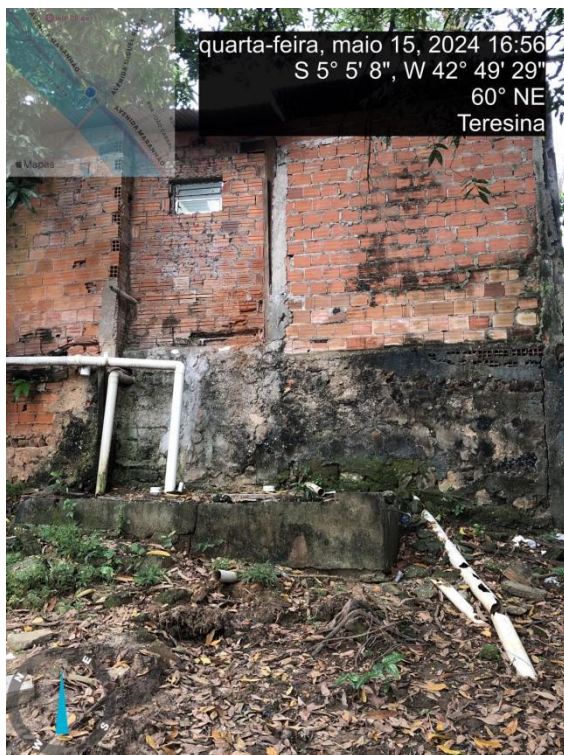
Figura 29 - Construções e detalhamento de disposição irregular de efluente na margem do rio.
