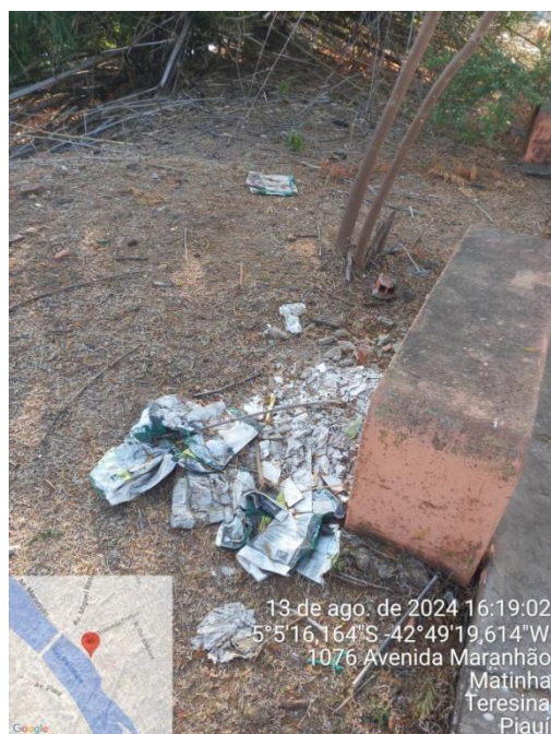
Figura 25 - Presença de Resíduos Sólidos de Construção Civil.
