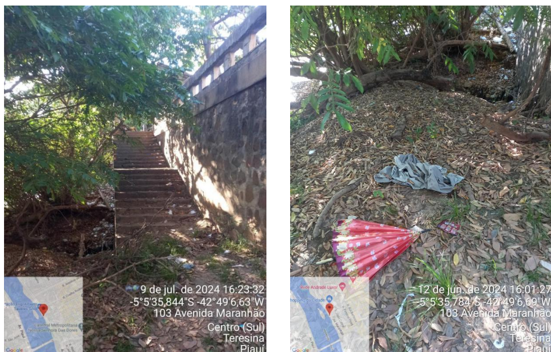
Figura 21 - Presença de Resíduos Sólidos, Galeria de Drenagem e Vegetação Antropizada.
