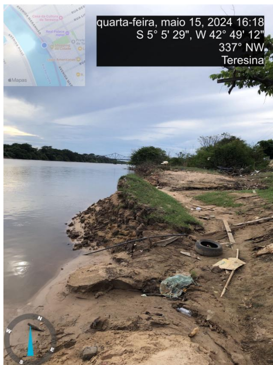
Figura 22 - Supressão vegetal, Intensificação dos processos erosivos do solo e a presença de resíduos sólidos.
