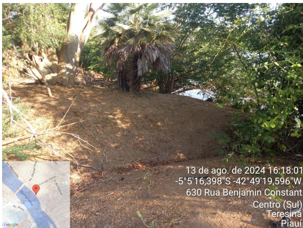
Figura 28 - Solo desprotegido, intensificação dos processos erosivos.
